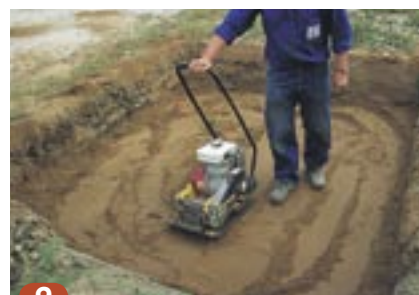
9 Vælg tilfyldningsmateriale og udfør tilfyldningen, så den opfylder krav til ydre forhold og konstruktionen ovenover, fx vejkonstruktion.
