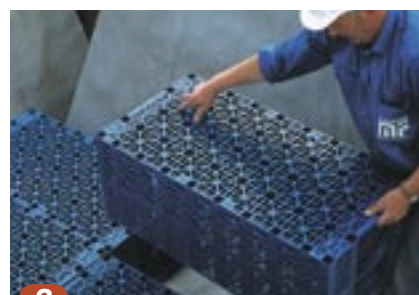
3 Læg et 10 cm udjævningslag i udgravningen. Udgravningen fores med geotekstil med min. 30 cm overlæg, og kassetterne installeres.
